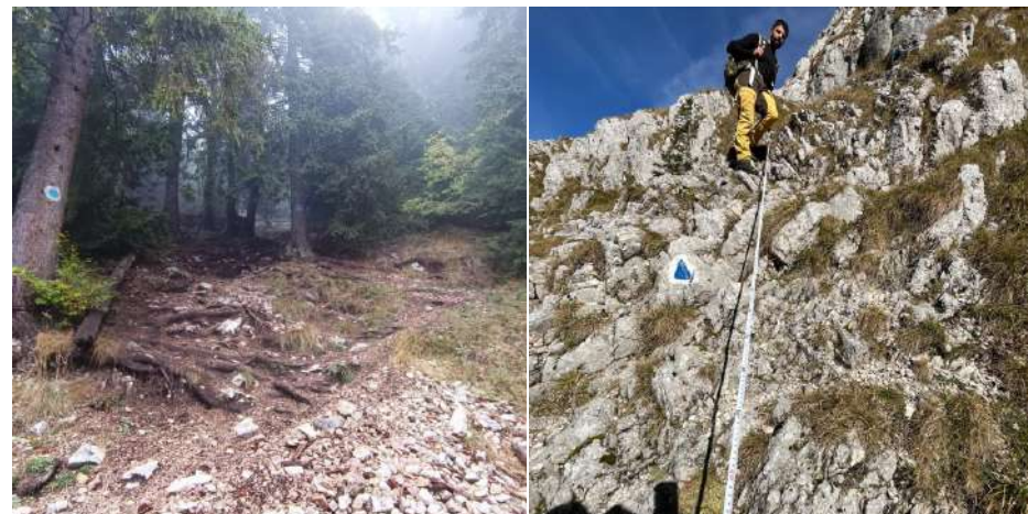
Evaluări ale traseelor turistice degradate de eroziune
